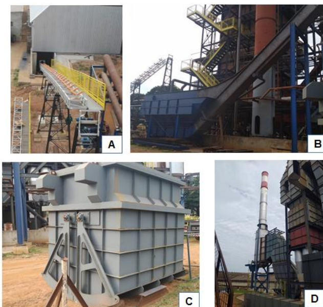
A) Esteira condutora; B) Decantador; C) Silo de fuligem; D) Chaminé
