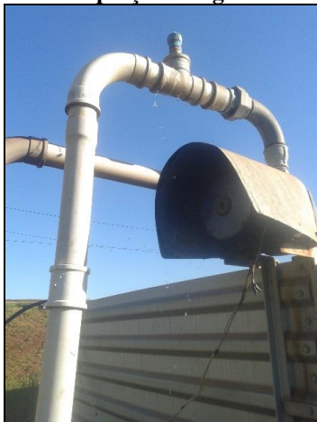
Fotografia 4- Gargalo em tanques de captação de água
