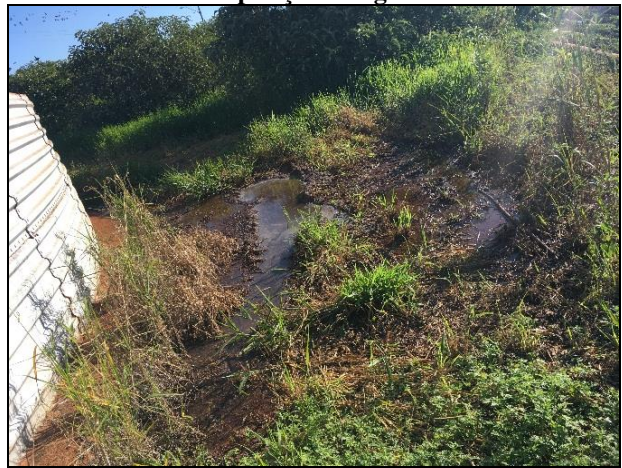
Fotografia 5- Vazamento de água pelo tanque de captação de água
